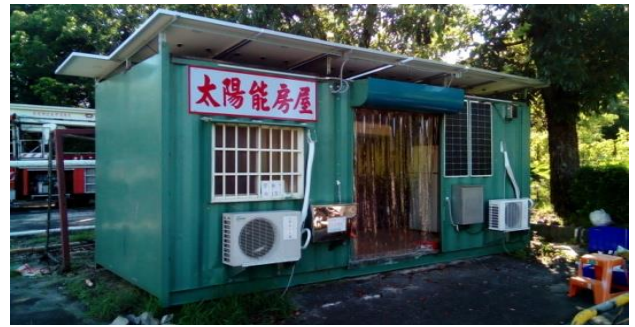
圖2. 安裝太陽能冷氣機之方便移動的貨櫃屋
