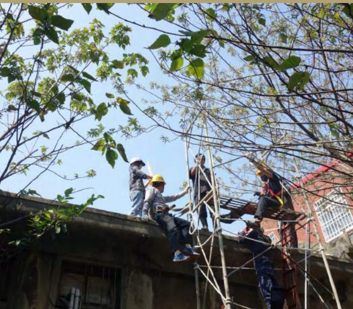
▲ 屋頂修整。年久失修的倉庫漏水嚴重，是團隊成員極為頭痛的問題。
